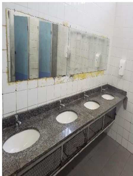
Figura 12 – Sanitário de aluno com pias danificadas
