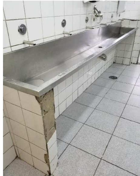
Figura 14 – Sanitário com pias danificadas
