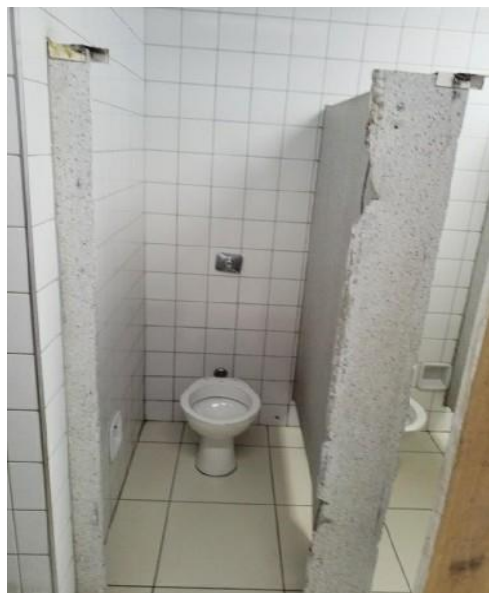
Figura 11 – Sanitário de aluno sem portas
