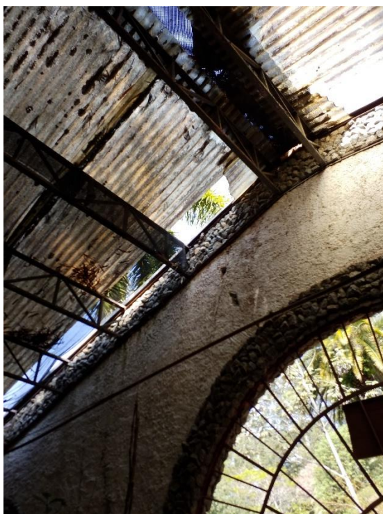
Figura 35 - Telhado quebrado (Parque Anhanguera)
