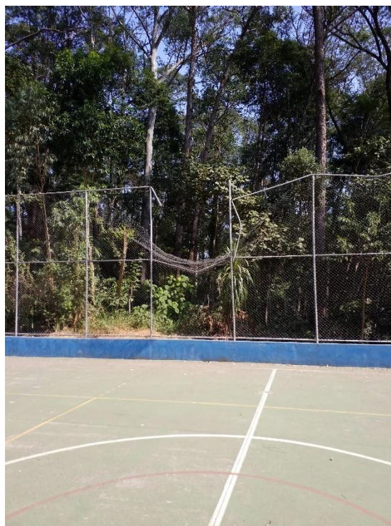
Figura 28 - Quadra mal conservada (Parque Anhanguera)
