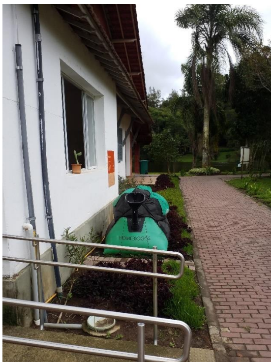
Figura 65 - Boa prática "Biodigestor" (Parque Nascentes do Ribeirão Colônia)
