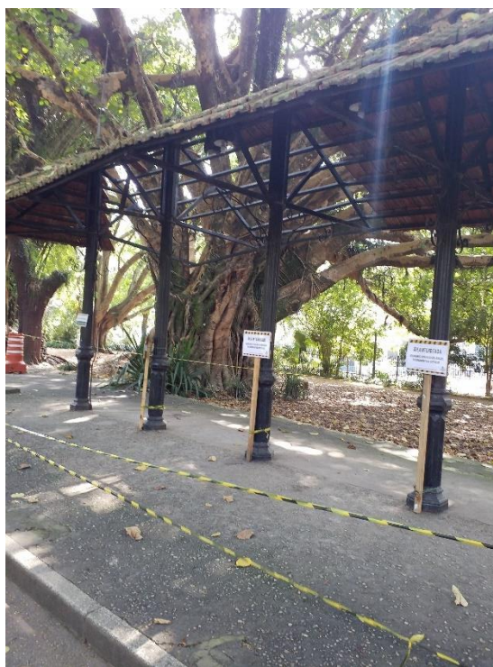
Figura 36 - Telhado quebrado (Parque Jardim da Luz)
