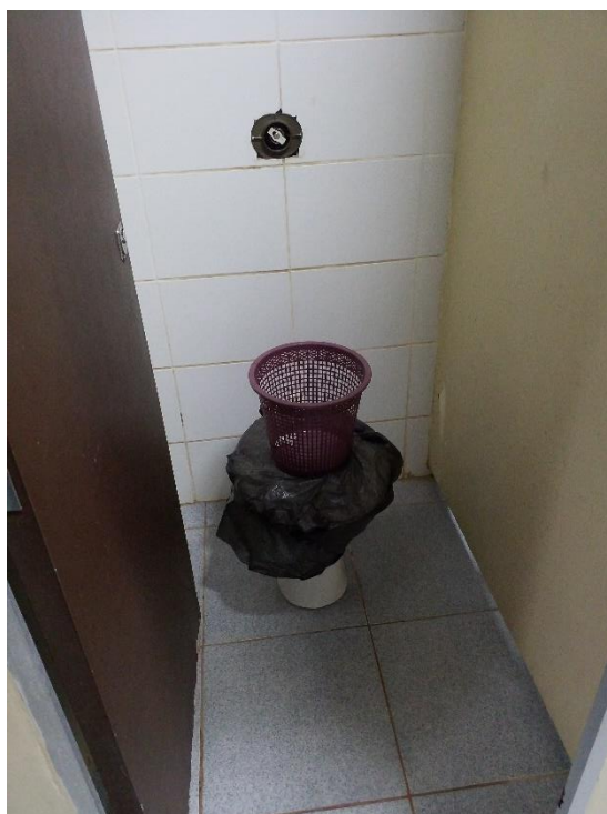
Figura 38 – Sanitário mal conservado (Parque do Carmo)
