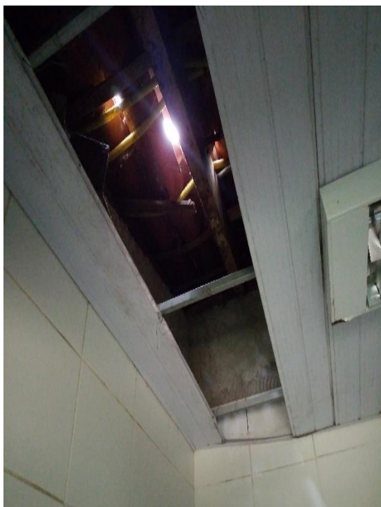
Figura 37 – Sanitário mal conservado (Parque do Carmo)
