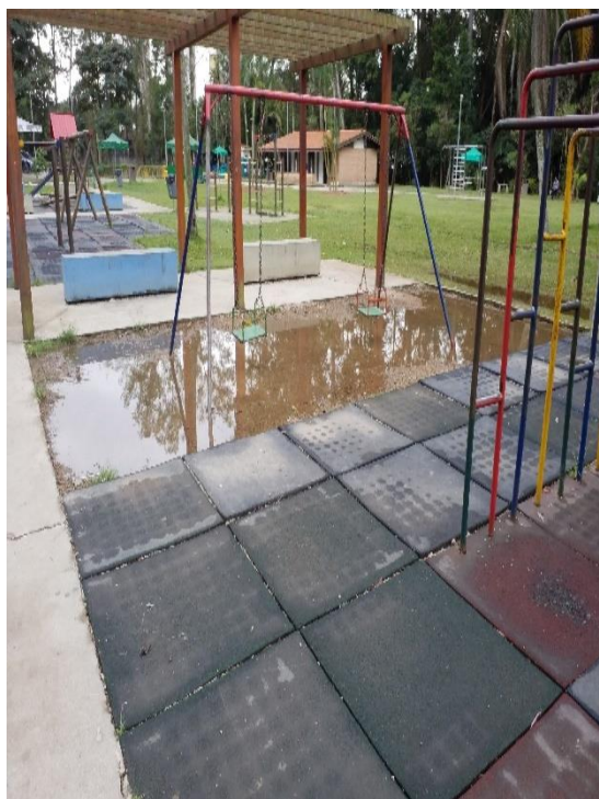
Figura 18 - Playground alagado (Parque do Carmo)
