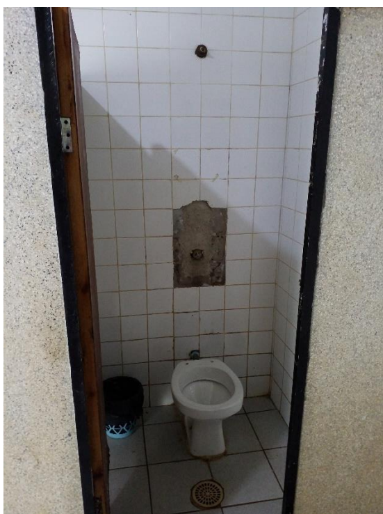
Figura 39 – Sanitário mal conservado (Parque Chico Mendes)
