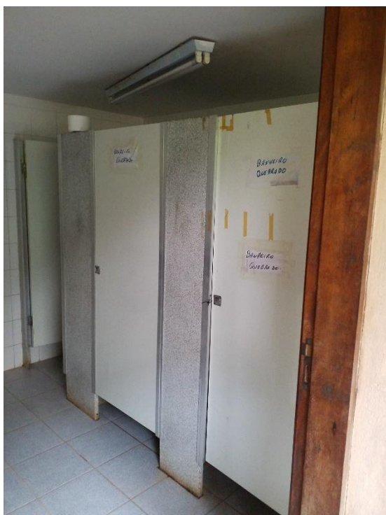
Figura 41 – Sanitário mal conservado (Parque Jardim Herculano)
