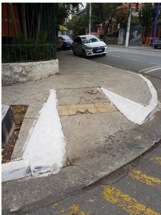
Figura 43 – Rampa mal conservada (Parque Aclimação)
