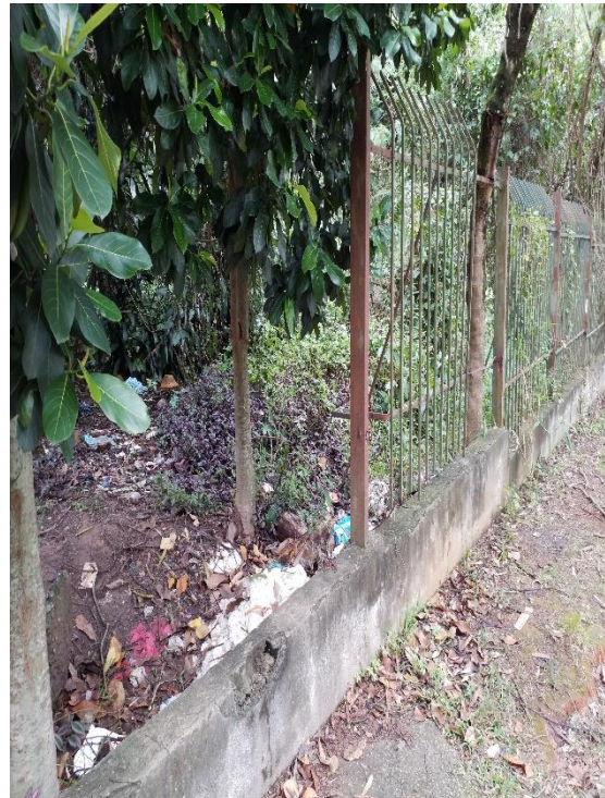
Figura 04 – Gradil mal conservado (Parque do Carmo)
