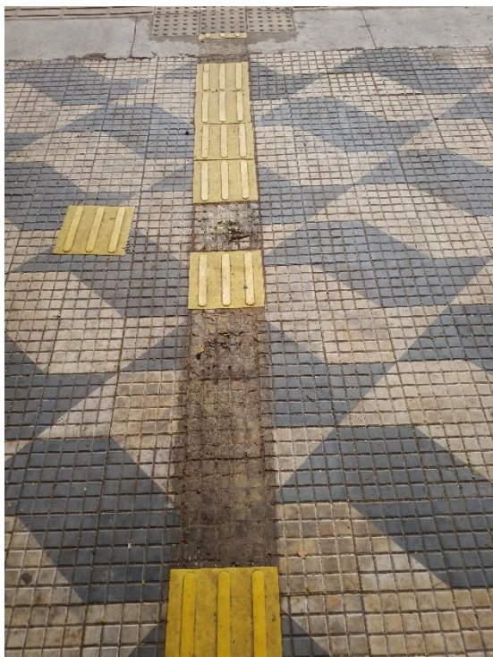
Figura 45 – Piso tátil mal conservado (Parque Independência)
