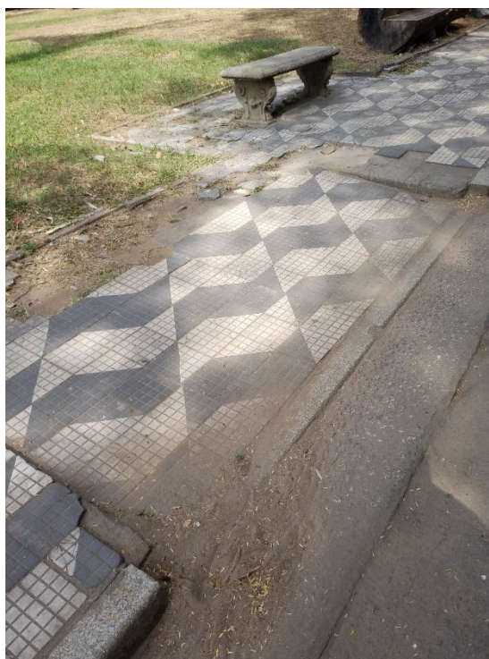
Figura 44 – Rampa mal conservada (Parque Jardim da Luz)
